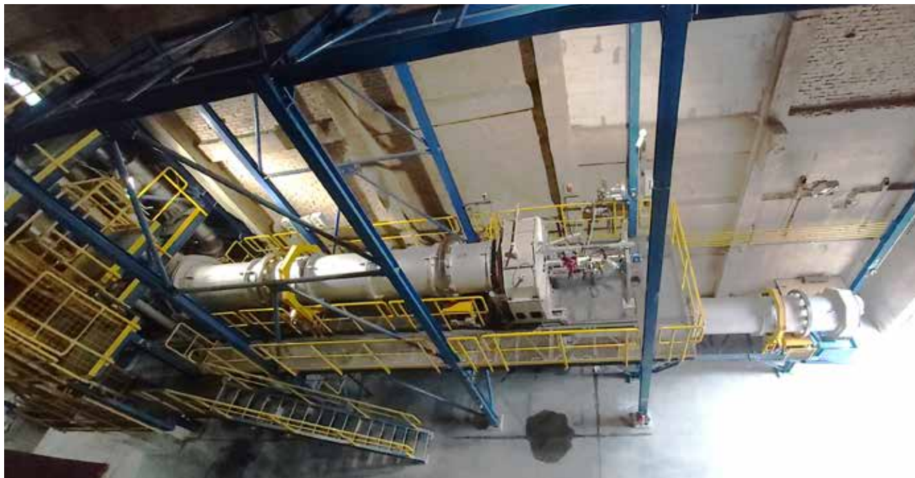
Rotační pec na pracovišti CirkTech v Čížkovicích
